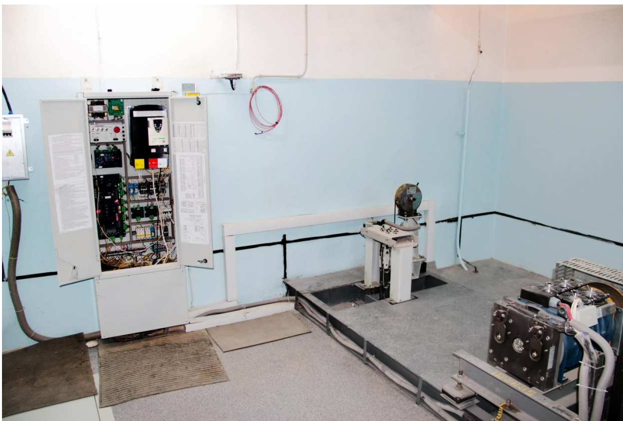
Рисунок 13 Машинное отделение грузопассажирского лифта в зд.100 6 эт.
