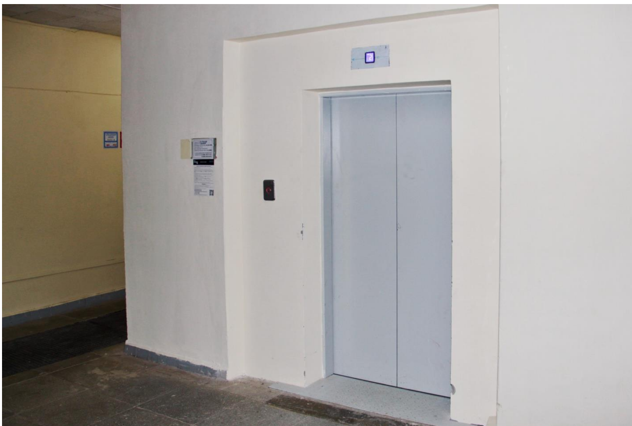
Рисунок 11: Новый грузопассажирский лифт 1000 кг в зд.100
