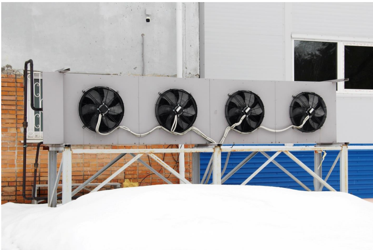
Рисунок 2: Перемещение наружного блока ВТХО
